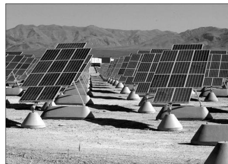
Fig. 2.9. Unit of PV Array
